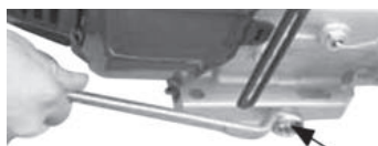
Tapón de drenaje
